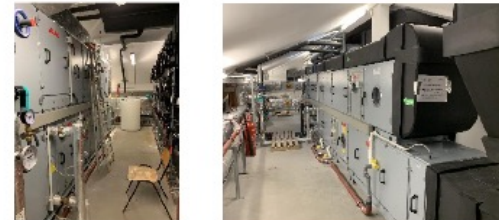
Umschleifende Regelung der Lüftungsanlagen
