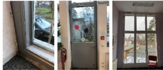
Fenster/Türen teilweise mit Einfachverglasung Einfachverglasung Übergang Haus ID
