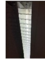
Beleuchtung bereits zu 100% durch LED Leuchtentdecken ausgetauscht
